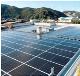
和歌山工場屋上の太陽光パネル(2025年撮影)
